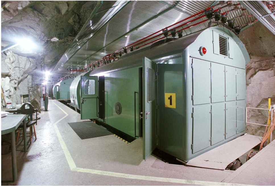
Figur 2 Maskinsalen i Grängesbergs omformarstation med två omformarvagnar Q 2 4/Q 2 5 och en transformatorvagn Q 2 6 – likadana fanns i Skogstorp. Foto Peter Löf
