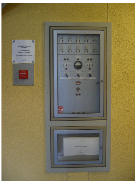
Figur 17 Brandlarmsanläggning i den inre entrén 003B.
