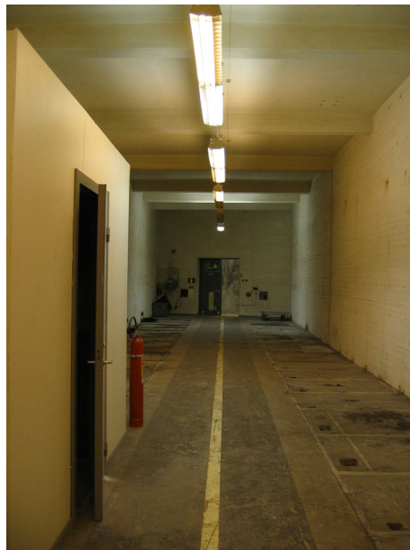
Figur 40 Det största ställverksrummet – jämför med figur 3.
