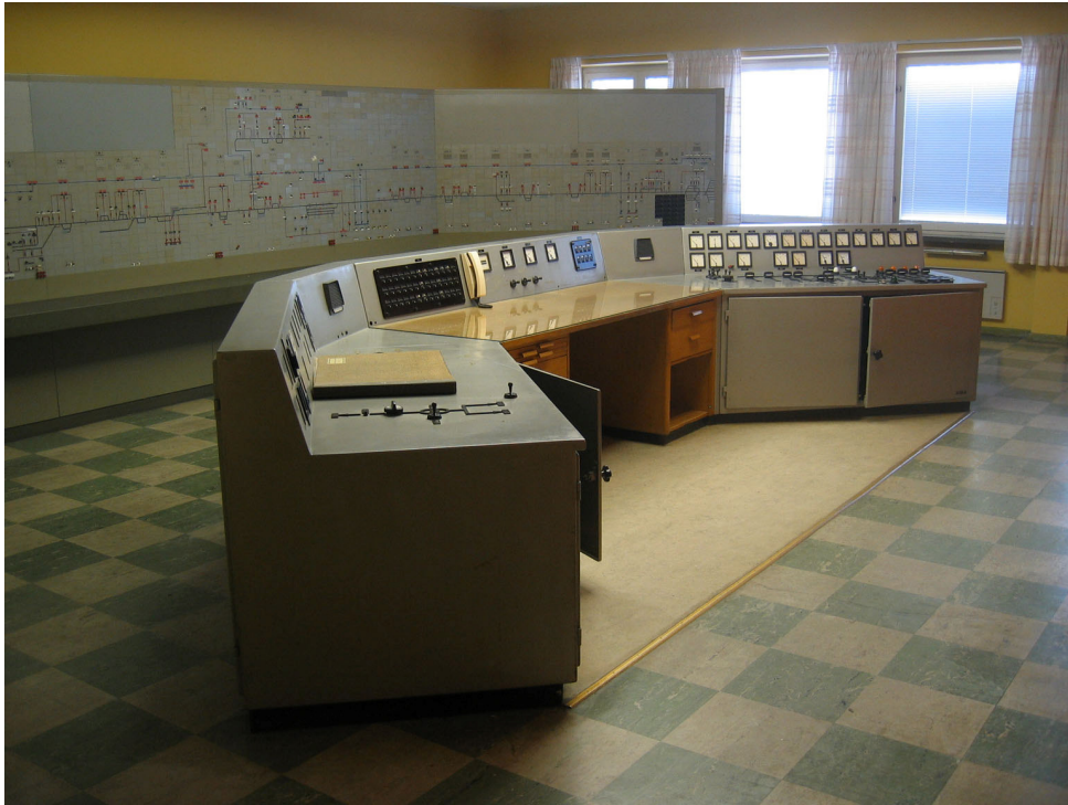
Figur 20 Eldriftvaktens rum 001 med kontrollbordet i förgrunden och dess indikerings- och manöverpanel i bakgrunden
