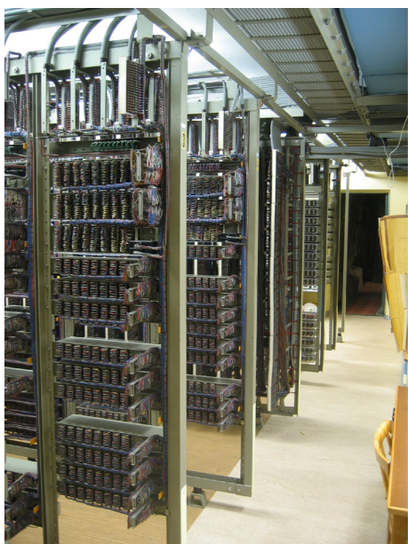
Figur 15 Stativ med signalutrustning i relärummet 001.
