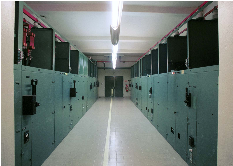
Figur 3 Ställverket i Grängesbergs omformarstation med högspänningsutrustning bakom enkla plåtdörrar liknande de i Skogstorp. Foto Peter Löf
