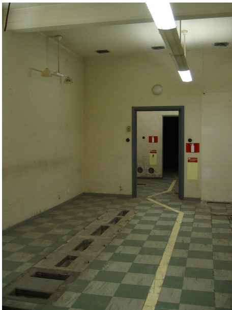
Figur 39 Det mittersta ställverksrummet med blågrön-grå linoleummatta.
