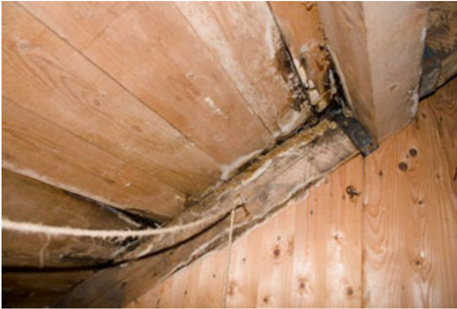
Del av rötskadad takstol på vinden.
