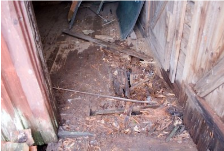
Skadat golv i uthuset orsakat av läckande tak.
