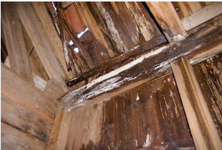
Rötskadat hammarband ovanför ingången till rum 102
