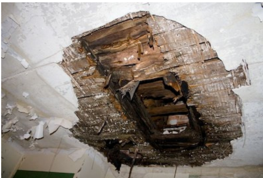
Rötskada i mellanbjälklaget ovanför köket.
