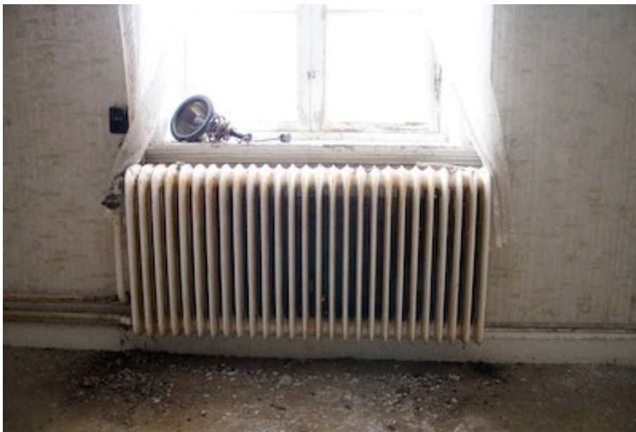
Radiatorn i sovrummet på vinden.
