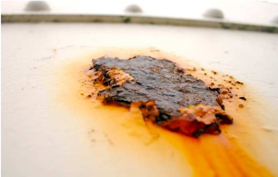
Rostskada i plåten som byggt på drygt en centimeter.
