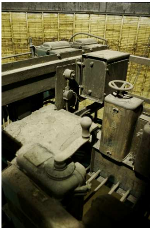
Förrarplatsen på manöverplattformen med jutesäcken och styrkontrollerna. Foto Rasmus Axelsson
