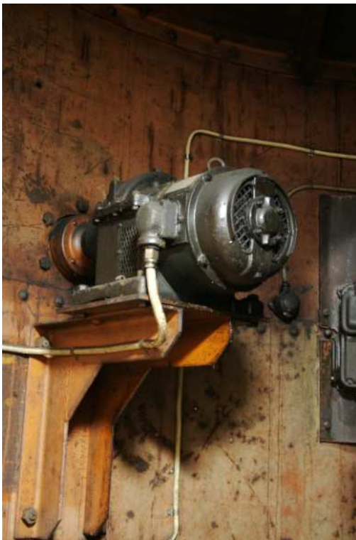
Matarbordets drivmotor på väggen på den fjärde nivån
