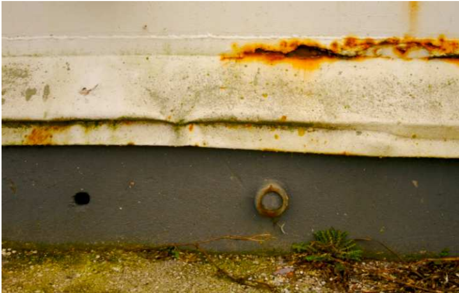
Sockeln, ventilationshål och den rotskadade skyddsplåten.
