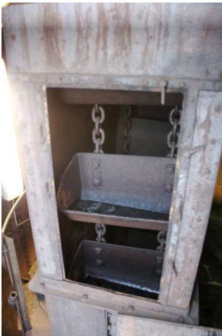
Elevatorskopa med råsocker i
