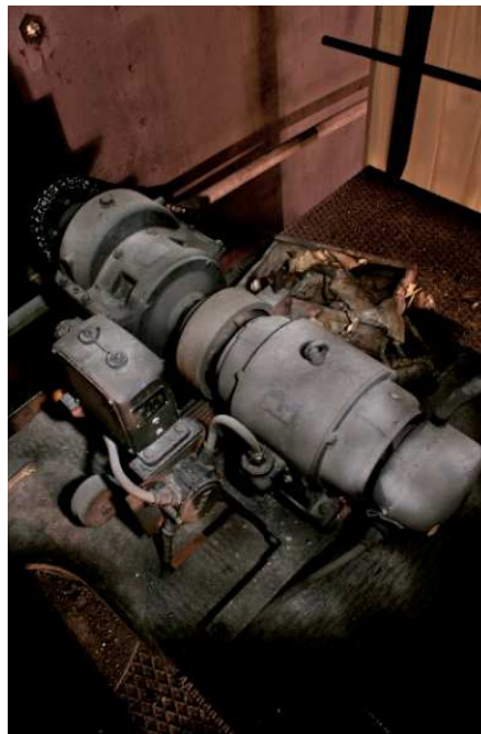
Elmotorn som drev traversen. I bakgrunden syns röret på väggen och ett igentäppt ventilationshål
