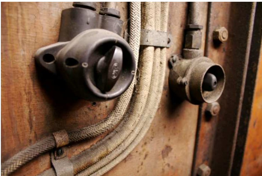
Elkablar och två strömbrytare av bakelit och metall invid dörren på den femte nivån i tornet.
