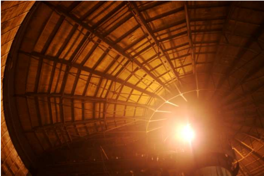
Innertaket med spår av igensatta takfönster.
